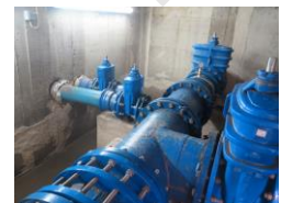
Fig.VI – Câmara de manobras da Camara de Perda de Carga (CPC) da Feteira.
