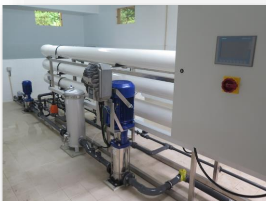
Fig.VIII – Sistema de Osmose Inversa, nascente do Rêgo, freguesia das Sete Cidades.
